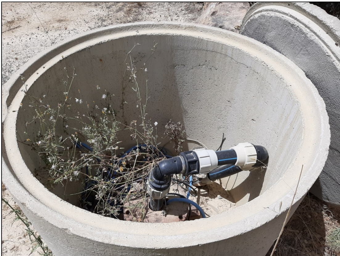
Figure 13. Forage alimentant les sanitaires et le système d'aspersion
